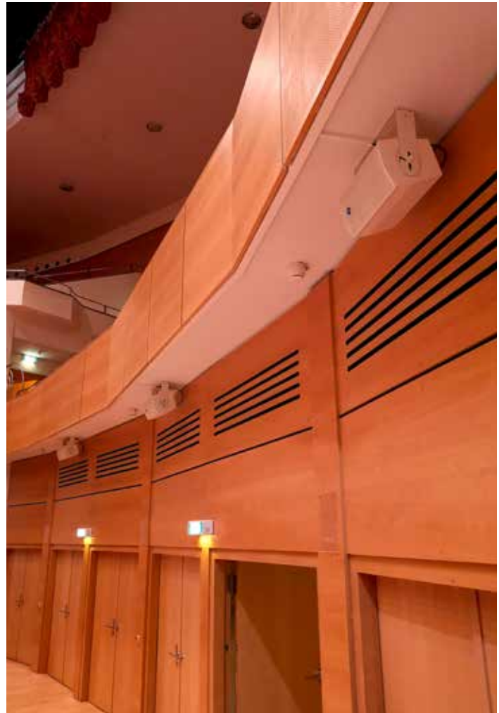
Akustik für viele Konzerttypen: 35 neu installierte und 74 bereits vorhandene Lautsprecher sorgen für eine gleichmäßige akustische Abdeckung
